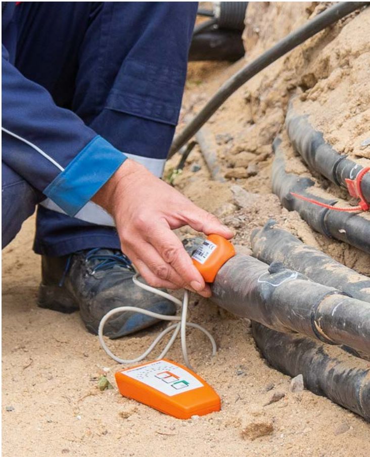
Die Schadstelle wird lokalisiert und gemeldet.
