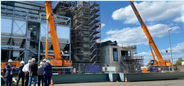
2023 einsatzbereit: Die Monoverbrennungsanlage im Chemiepark Bitterfeld-Wolfen.
